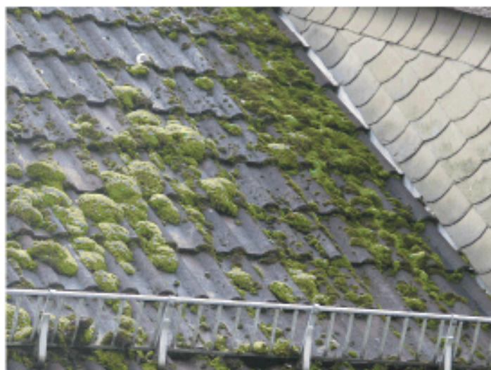
Zerbröckelnde Ziegel auf dem Dach des DGH
